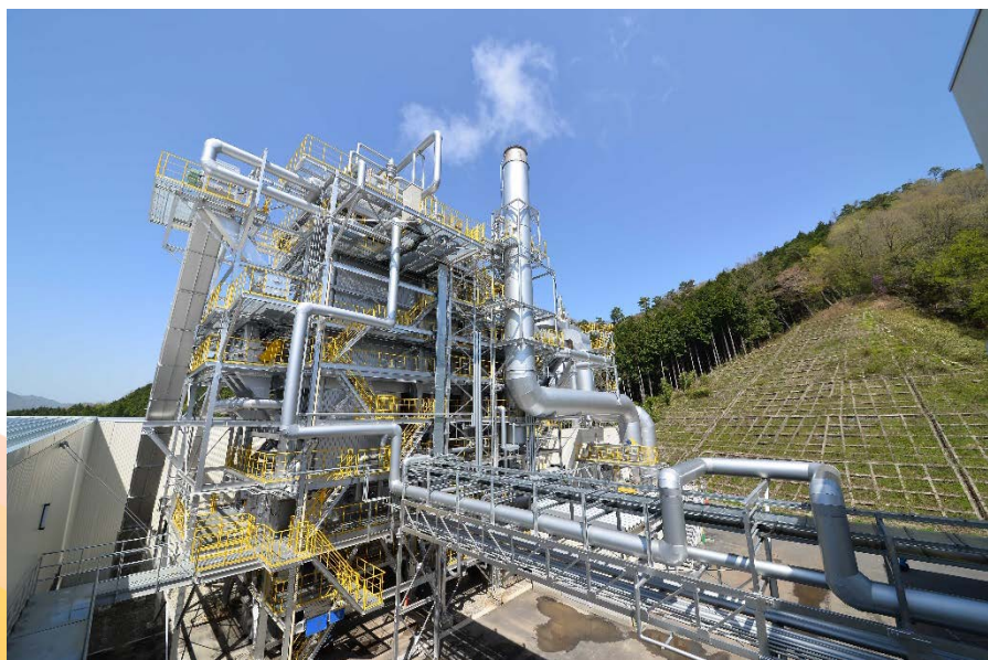
バイオマス発電所
