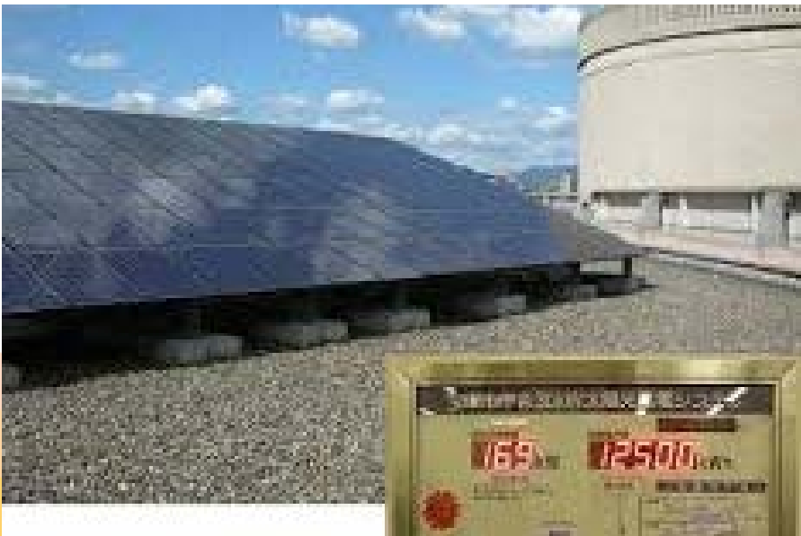
市庁舎屋上太陽光
