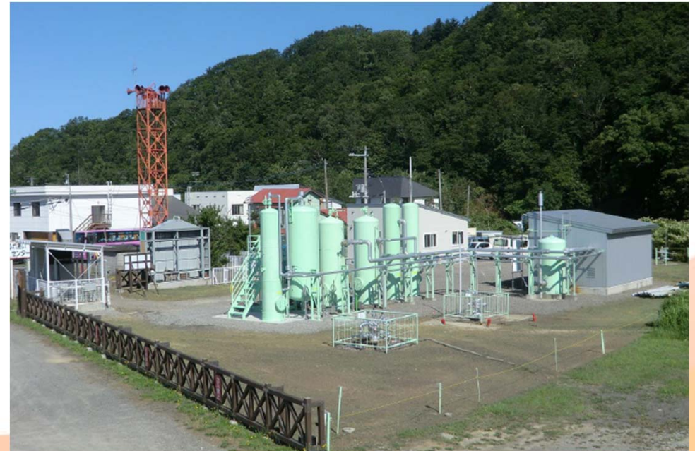
豊富鉱山施設 (天然ガス)
