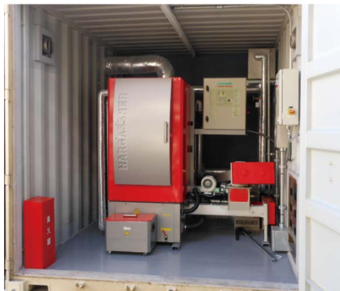
図2 木質バイオマスボイラ(自社利用)
