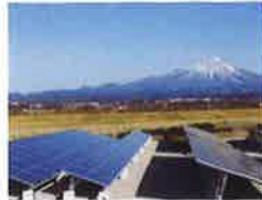
企業局西部事務所太陽光発電所 (米子市八幡)
