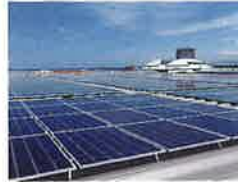
企業局FAZ倉庫太陽光発電所 (境港市竹内工業団地)
