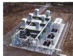
宍道湖東部消化ガス発電所 (松江市竹矢町)
