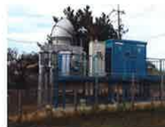
湯梨浜地熱発電所 (東伯郡湯梨浜町)
