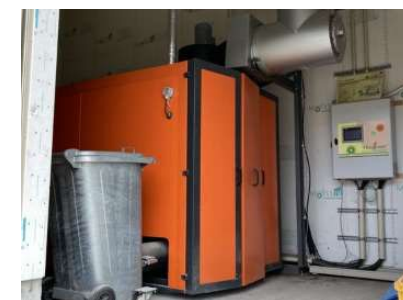
バックアップボイラー
