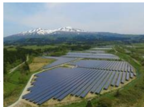
遊佐町に建設した「庄内・遊佐太陽光発電所」
